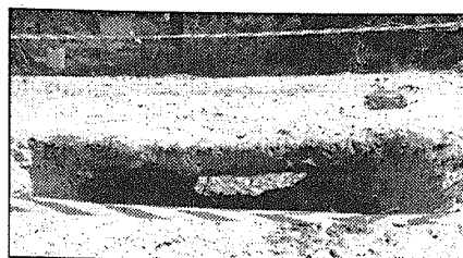
Unterhöhlte Zufahrtsstraßen zum Zwischenlager Gorleben
